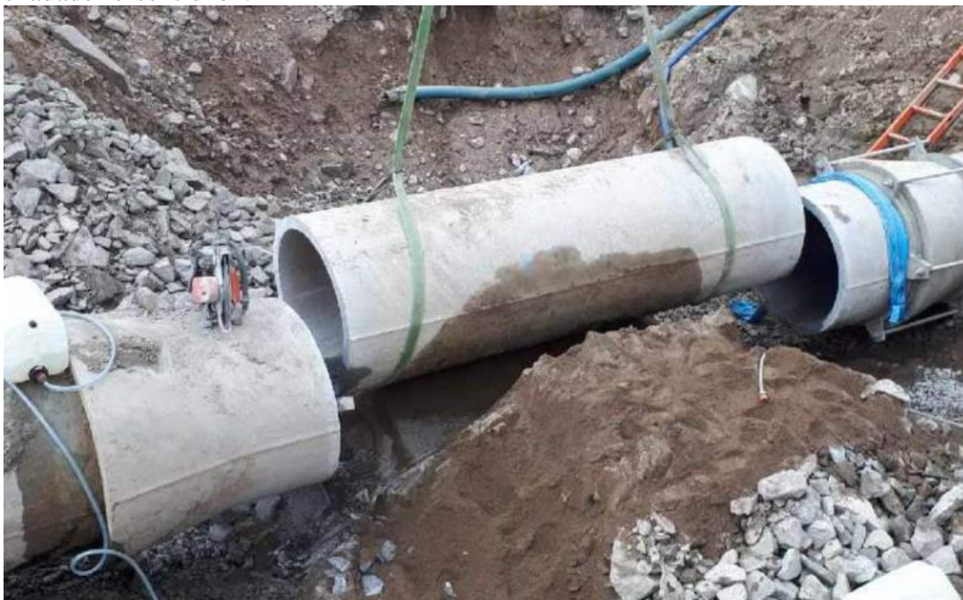
Figur 1:1 Det går ofta mycket tungt att dra ut rörbitarna, framför allt vid större dimensioner. Tänk på att skydda de fria rörändarna där sammanfogningen ska ske så att rörbiten som avlägsnas inte svänger loss och skadar dessa. Då måste även nästa rör bytas!
