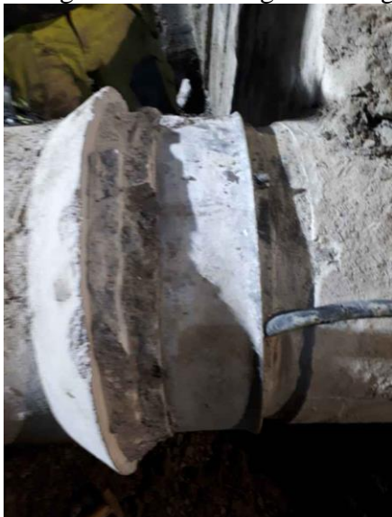
Figur 2:1 Bonnamuff med betongen avlägsnad.
